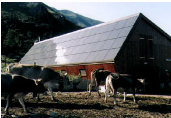
Fig 5.1.1: Die PV-Anlage Alp Findels liegt auf einer Höhe von 1650m.ü.M.
